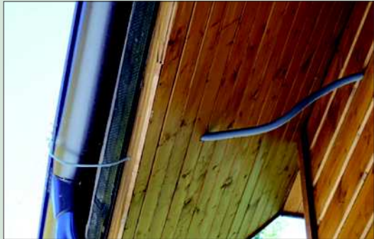
Obr. 1. Nevhodne spravený zvod
