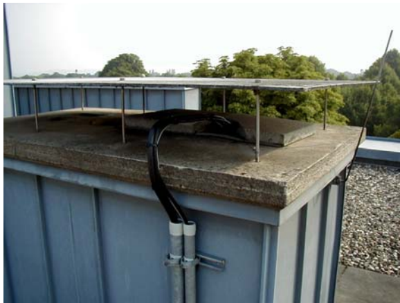
Bild 13 Die Energieversorgung der Mobilfunkanlage auf dem Dach wird durch einen Schornstein geführt. Die Mobilfunkanlage auf dem Dach ist direkt mit der Fangeinrichtung verbunden.
