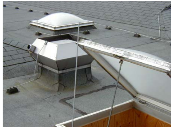
Bild 12 An der Stelle wo eine Fangstange sein muss, ist eine lange Fangspitze in der Nähe der Rauchabzugsanlage installiert. Im Hintergrund ist auch der falsch geschützte Elektroventilator zu sehen.
